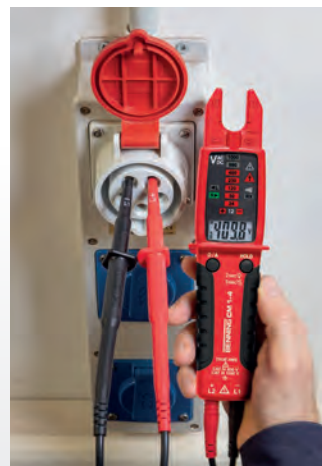
Spannungsmessung und Drehfeldprüfung
