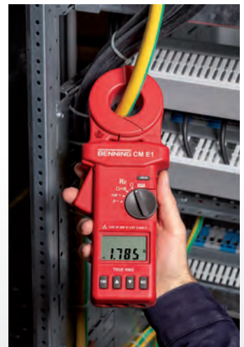
Messung des Betriebsrdes einer Industrieverteilung
