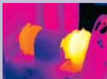
Перегрев крышки подшипника
